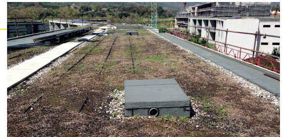
Concomitanza di errori. Sistema a Sedum, non a norma, dopo 3 anni circa dalla realizzazione. Sud Italia, 2010-2015.
